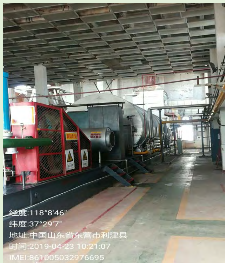
图 5-4 30t/h 注汽锅炉
